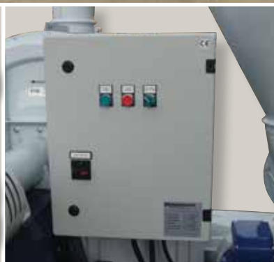
Caja de control para inicio/parada automático del motor.
